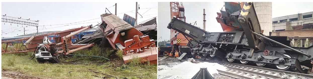
Рис. 63. Падение крана ОАО «РЖД» при проведении аварийно-спасательных работ краном по освобождению железнодорожных путей после схода грузовых вагонов
