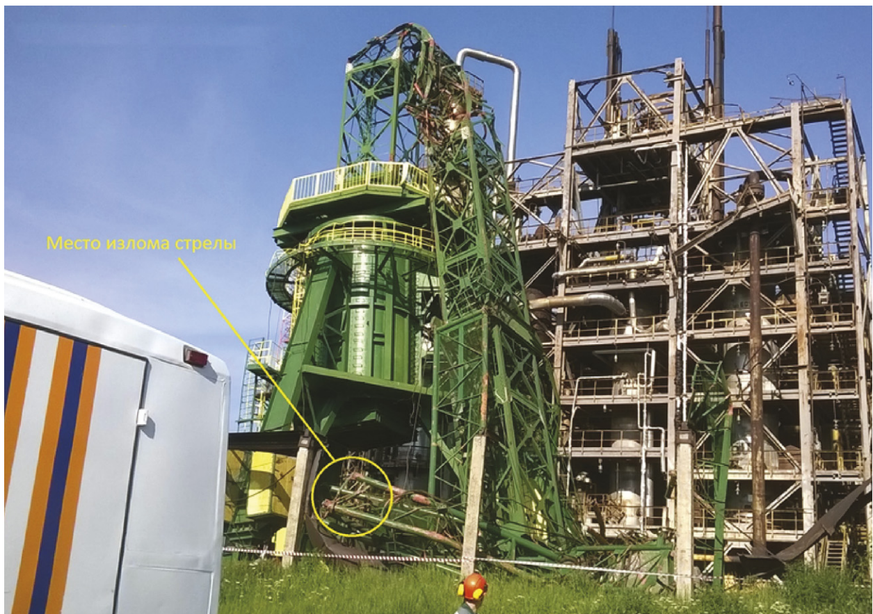
Рис. 67. Падение башенного крана БК-1000А и разрушение его металлоконструкций при монтаже в г. Кирово-Чепецк
