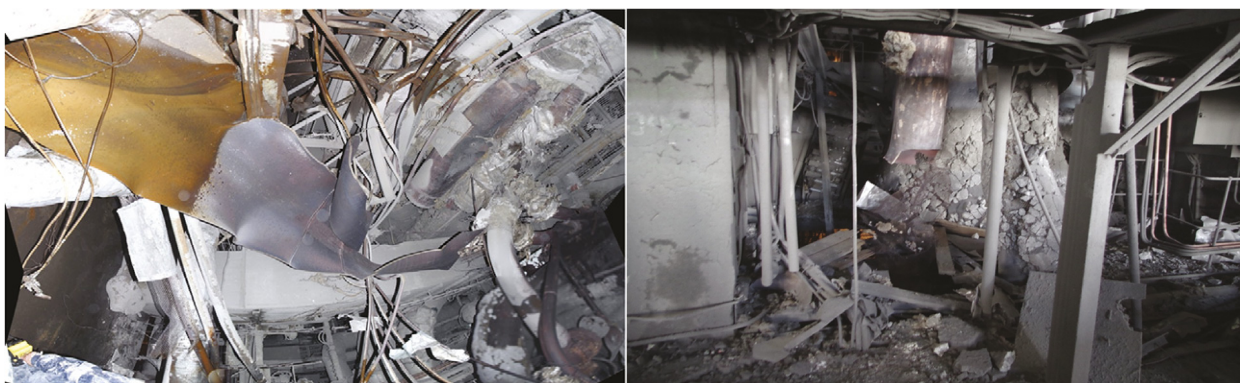
Рис. 44. Разрушение трубопровода холодного промперегрева энергоблока в главном корпусе филиала «Черепетская ГРЭС им. Д.Г. Жимерина» АО «Интер РАО-Электрогенерация»
