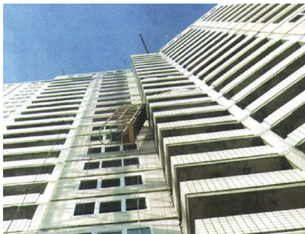
Рис. 64. Срыв одного из 4 несущих тросов с одной стороны люльки на строительстве жилого 21-этажного здания в Саратовской области
