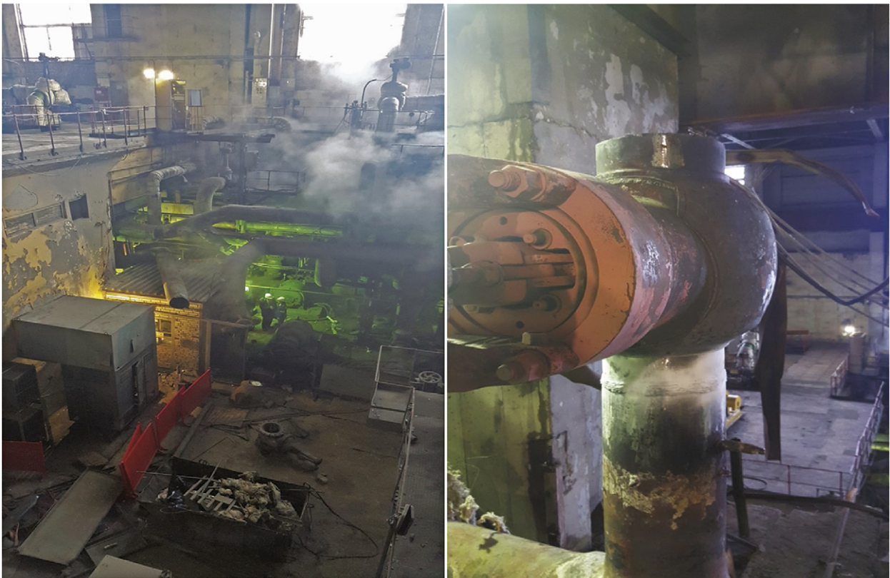
Рис. 43. Разрушение по сварному соединению на Первомайской ТЭЦ (ТЭЦ-14) филиала «Невский» ОАО «ТГК-1»
