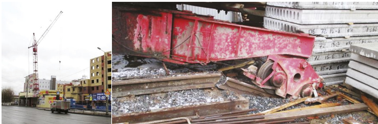
Рис. 66. Облом обоих опорных рельсов в конце рельсового пути на строительстве жилого дома в г. Архангельске
